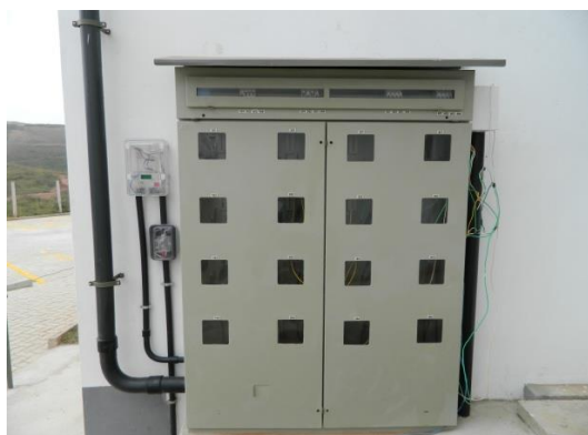
Painel de Medidores da Ligth - Externo
