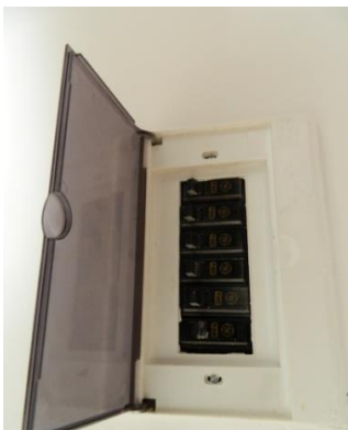
Quadro de disjuntores - Interno
